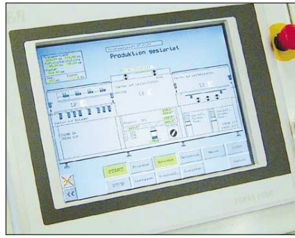
Bild 3: Anlagensteuerung durch Touchscreen Monitor
